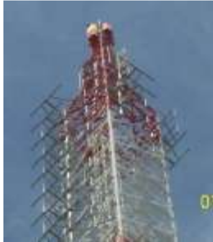
Fig. 4-5 Antena transmisora ubicada cerro Pichincha
