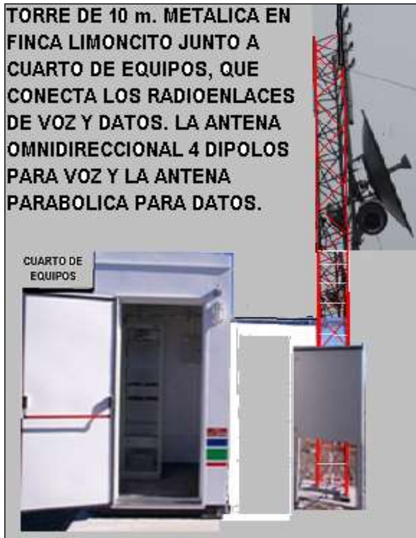
Figura 6-8 Cuarto de telecomunicaciones en Limoncito
