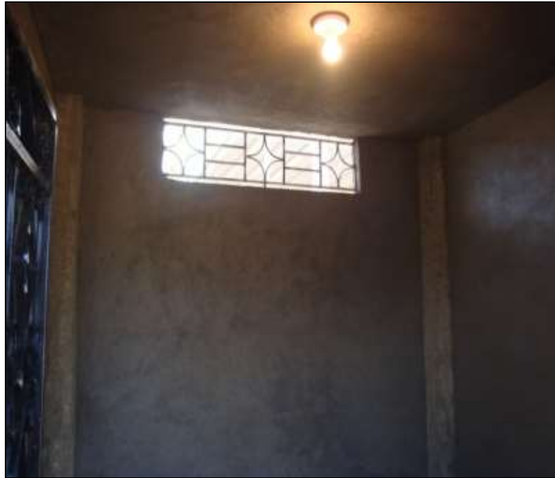
Figura 6-7 Iluminación y ventilación del cuarto
