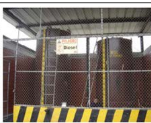
Fotografía 18. Tanques de almacenamiento de combustible (diesel) y su cubeto de seguridad.
