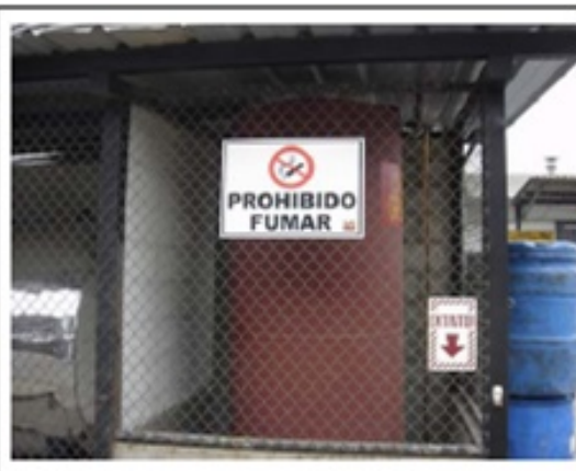
Fotografía 20. Tanque de abastecimiento de diesel para los calderos.
