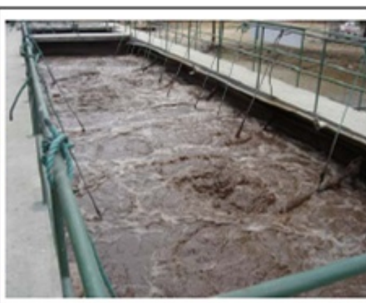
Fotografía 24. Reactor biológico de la planta de aguas residuales.
