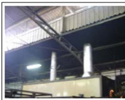
Fotografía 9. Vista del horno de cinta del Area de Repostería.
