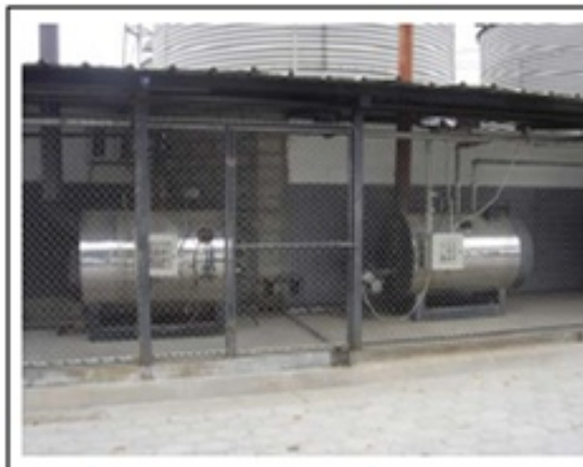
Fotografía 19. Vista de los calderos de la planta.
