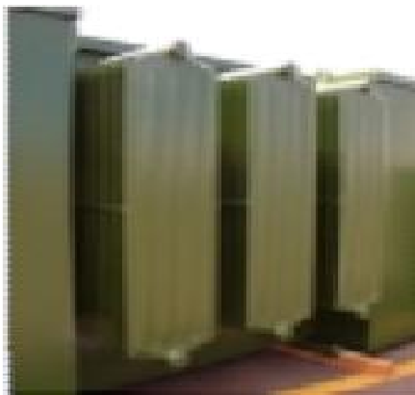
FIG. 2.3.17.1 RADIADORES DE REFRIGERACION
