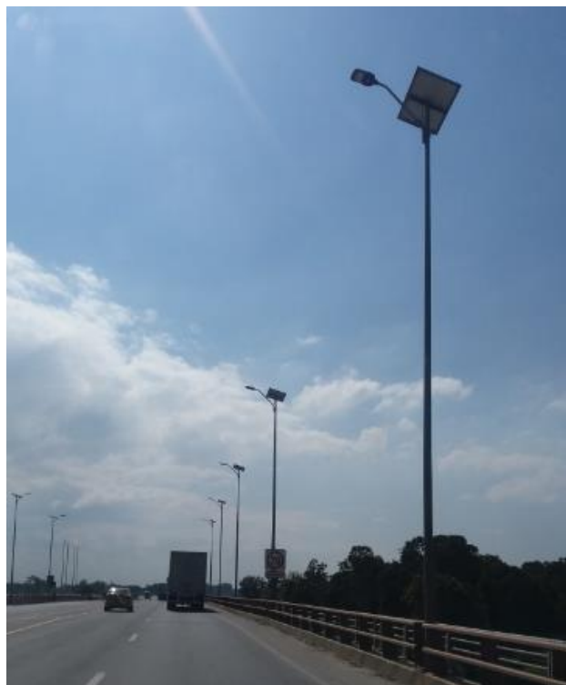
Figura 2. 9: Sistema de iluminación con paneles solares. Fuente: Autor
