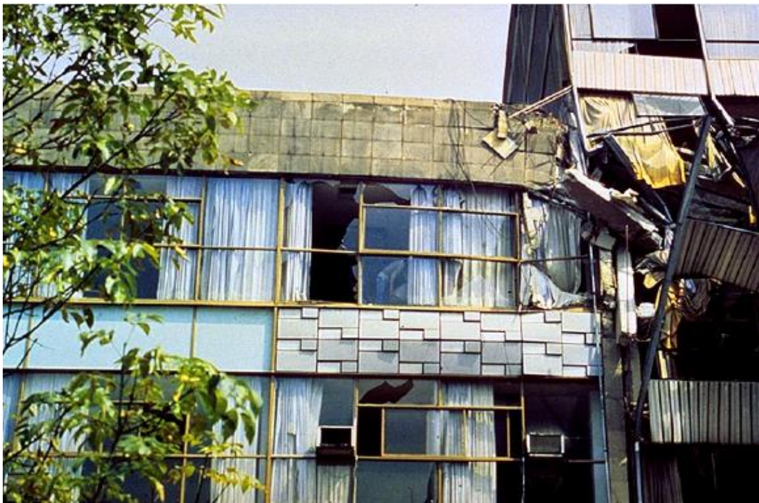
Figura 9.- Daño de edificio debido al choque
