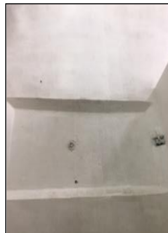
Pediluvio fuera de funcionamiento.
