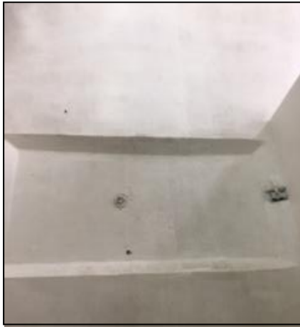
Pediluvio fuera de funcionamiento.
