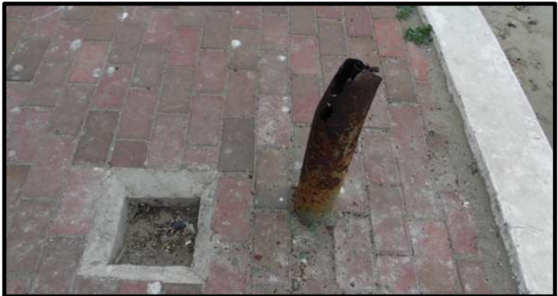
Ilustración 4.2:4: Poste deteriorado y removido Fuente: el autor
