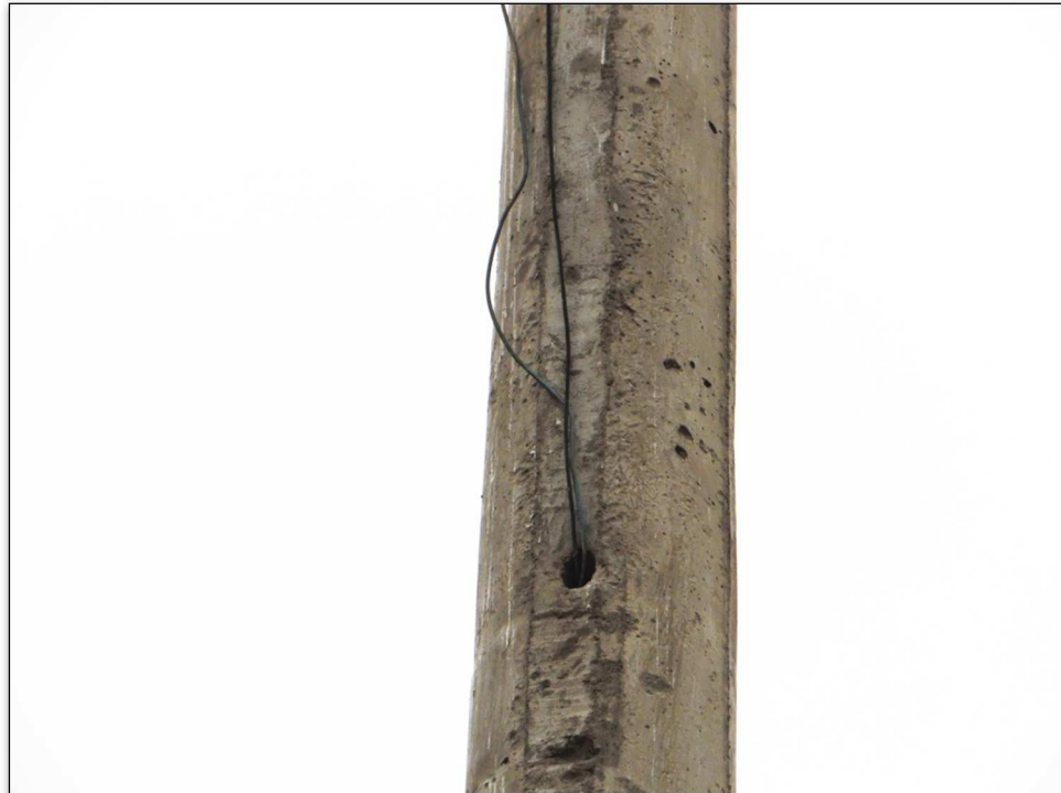
Ilustración 4.2:6: Conductores expuestos a la intemperie Fuente: el autor
