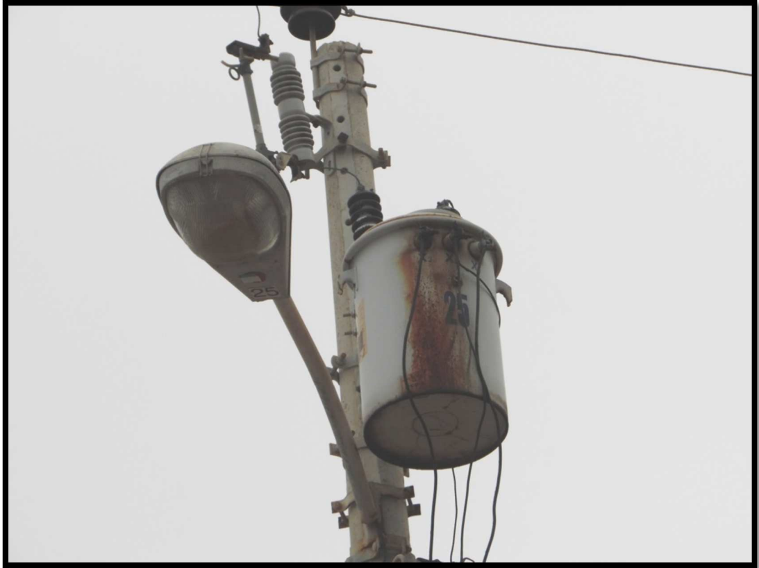
Ilustración 4.2:3: Estado del transformador de 25 kVA Fuente: el autor
