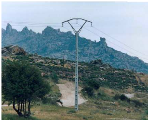
Figura 2.2 Poste de hormigón con cruceta metálica Fuente: Autor
