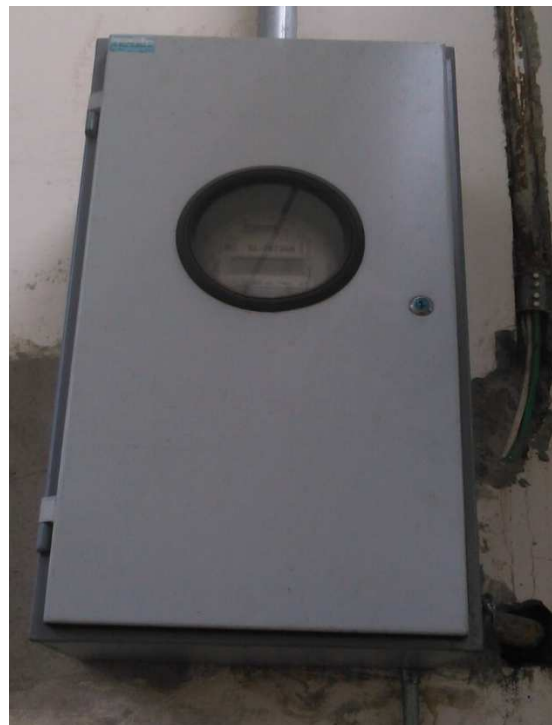
Figura 40 Caja de medidor nuevo de acuerdo al Napsin Fuente: J. Peralta, 2017
