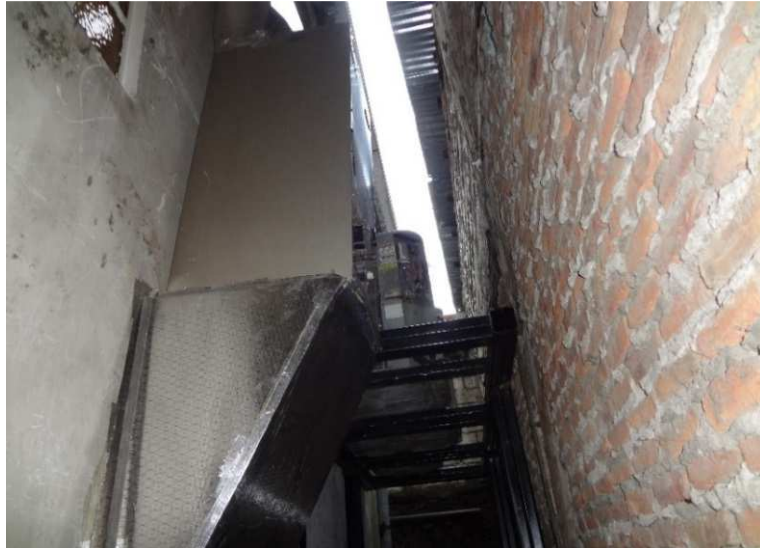
Figura 34. Ubicación Equipos de Centrales de Acondicionador de Aire Fuente. Iglesia Bautista Huerto del Gethsemani.
