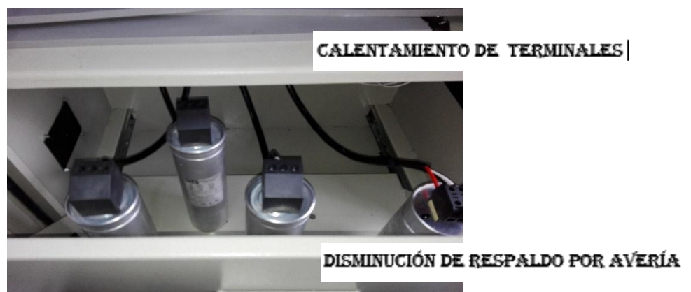
Figura 4.17 Banco de capacitores Fuente: Autor, Indeltro
