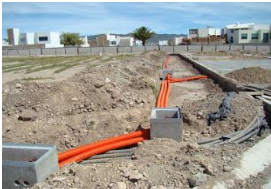
Figura 2.4 Instalación Subterránea eléctrica Fuente: (Instalaciones Electricas Residenciales, s.f.)
