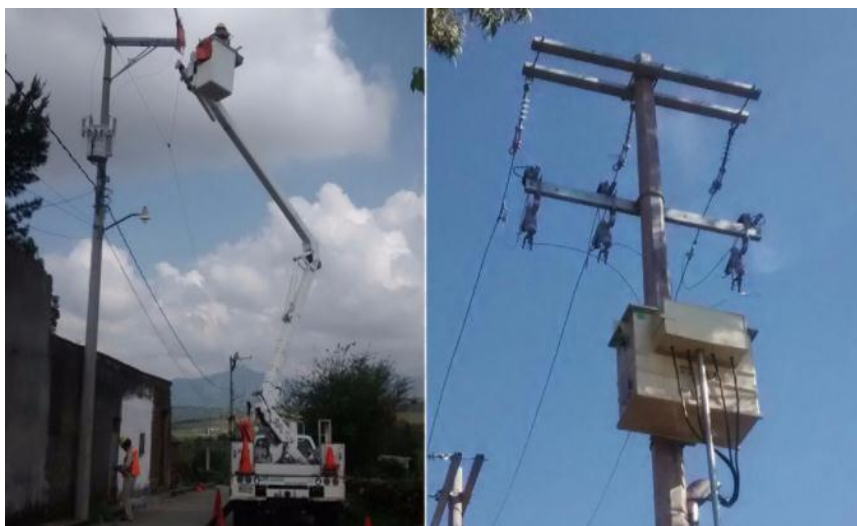
Figura 2.3 Instalación Eléctrica Aérea Fuente: (Electrica de Oriente, s.f.)
