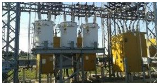
Figura 2.18 Subestación Electrica 69.000 Kv Fuente: (Ministerio del poder Popular para la energía electrica, 2016)
