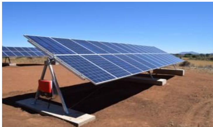
FIGURA 2. 24 Seguidor solar de un eje.
