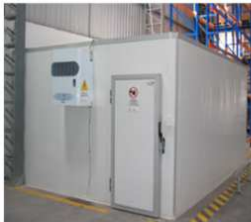
Ilustración # 17: Cámara de Frío
