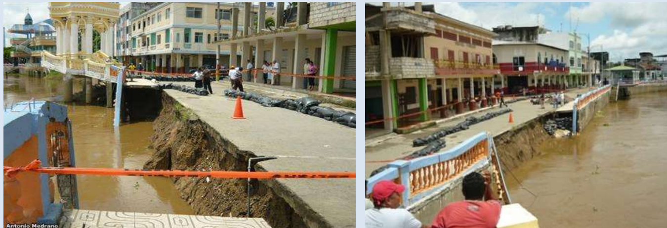
Ilustración 18 : Deterioro del Malecón de Vinces por las lluvias. Fuente: Foto diario la Hora, visitado 7 de junio 2012
