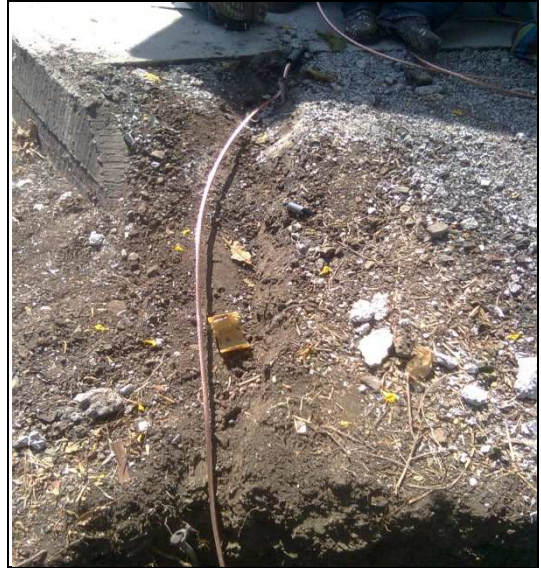
ENTRADA DEL CABLE 2/0 A CUARTO DE EQUIPOS
