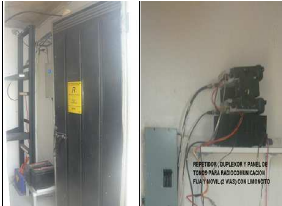
Figura 6.3 Rack para instalar equipos de voz y datos
