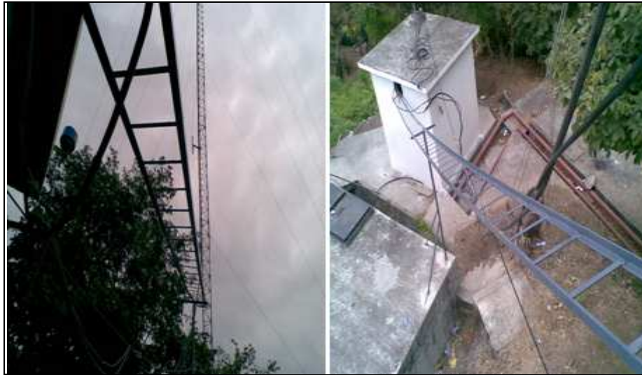
Figura 5.11 Bajante para cables RF que conectan con los repetidores en cuarto de Equipos
