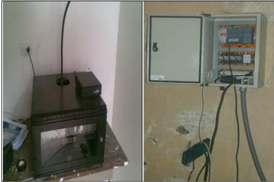
Figura 6.6 Equipo Repetidor de voz a 2 vías (guardianía y mantenimiento) y sistema con PLC para automatización del bombeo de agua potable en la UCSG
