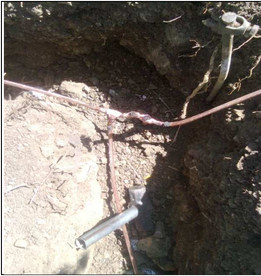
PUNTO DE SOLDADURA EXOTÉRMICA CABLE Y YOMPER HACIA LA BARRA
