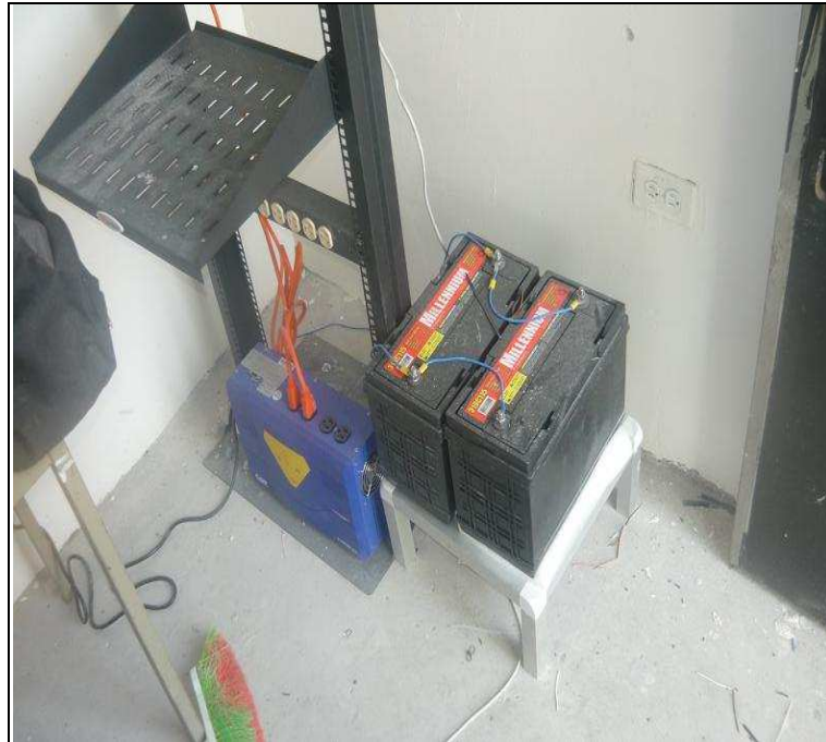
Figura 6.5 Supresor de sobre tensión + inversor y banco de batería
