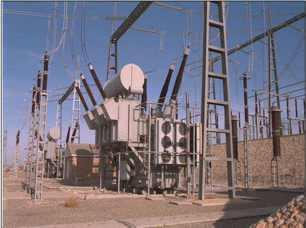
Figura 3.16 Subestación eléctrica con protecciones de auto válvula
