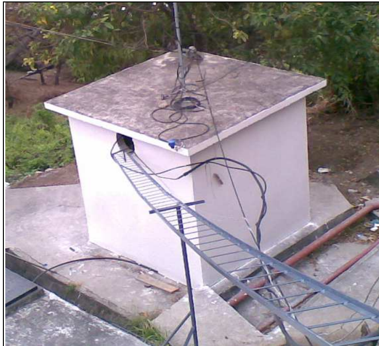
Figura 5.14 Cuarto de equipos donde se implementará sistema de aterrizamiento
