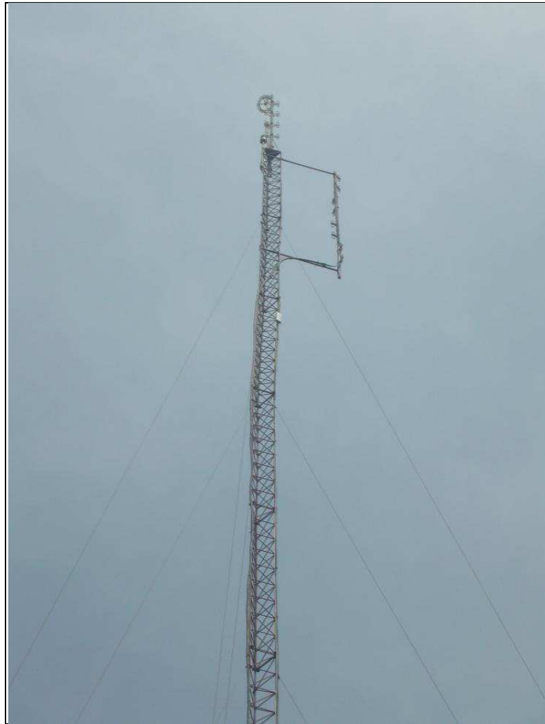
Torre con sistema de pararrayo, luz de baliza y bajante de cable RF
