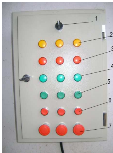
Figura 5.14: Vista frontal tablero control Twido (1) Selector manual.- Operador elige si trabaja en modo manual. (2) Luz piloto amarilla.- Nivel alto de agua. (3) Luz piloto roja.- Falla térmica. (4) Luz piloto verde.- Bomba en funcionamiento. (5) Botonera verde.- En marcha. (6) Botonera roja.- en paro. (7) Botonera tipo hongo.- Paro de emergencia.
