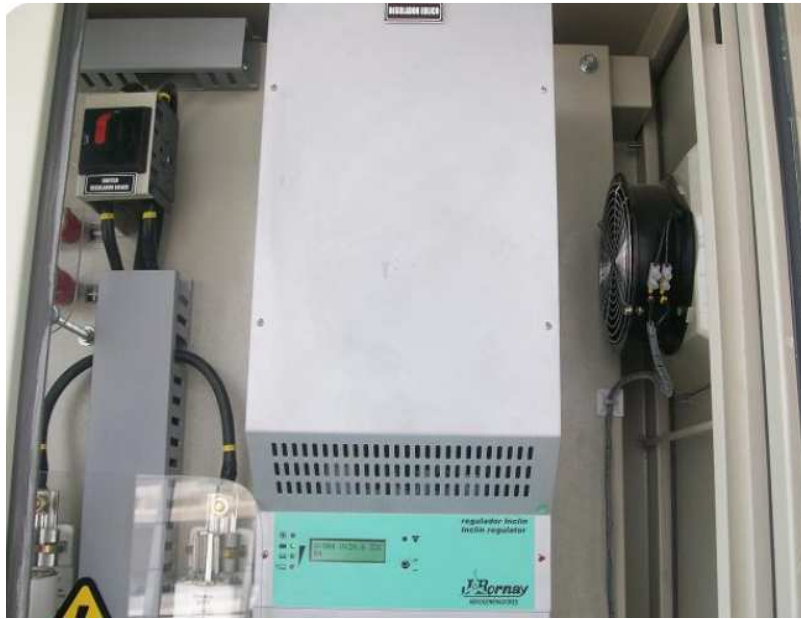
Figura 4. Panel de Control del Sistema
