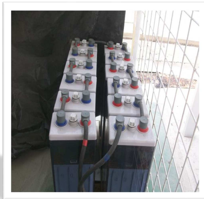
Figura 3. Banco de Baterías de Ciclo Profundo
