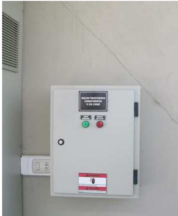
Figura 6. Tablero de Transferencia
