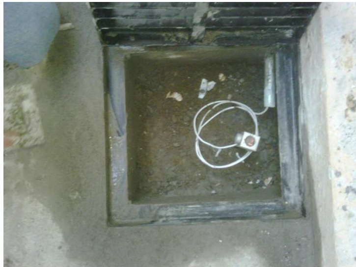
Figura 5.17 Sistema de puesta a tierra
