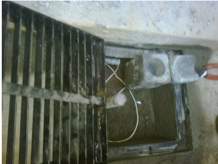
Figura 5.16 Sistema de puesta a tierra
