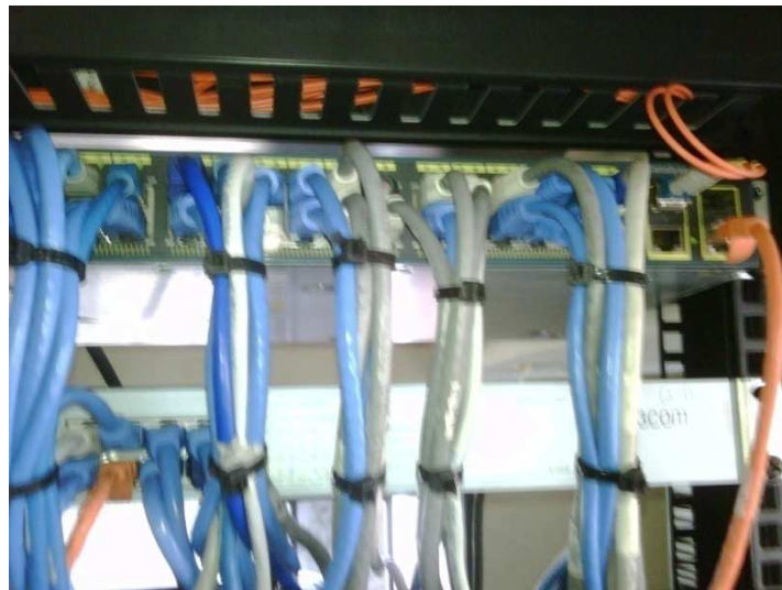
Figura 5.15 Cables de datos organizados
