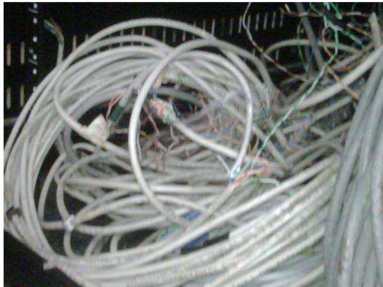
Figura 5.4 Estado del cableado en el rack anterior
