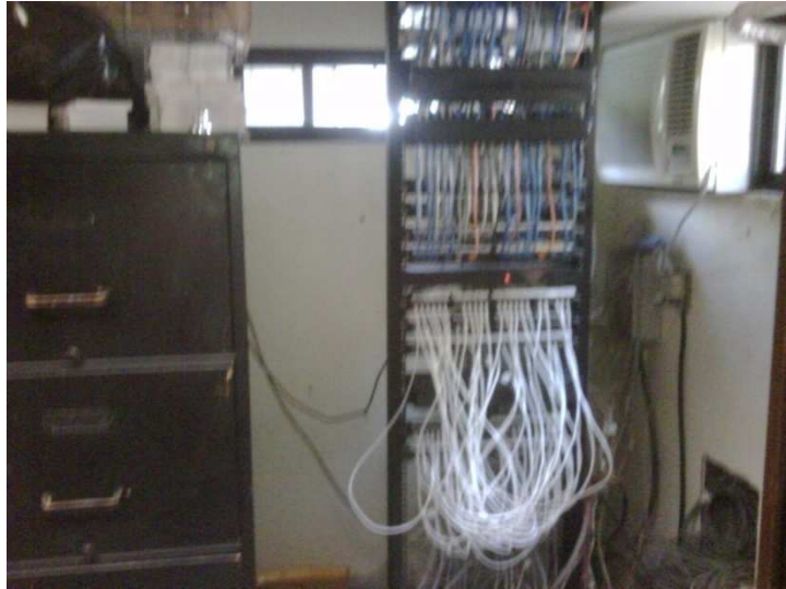
Figura 5.18 Conexiones en el nuevo rack
