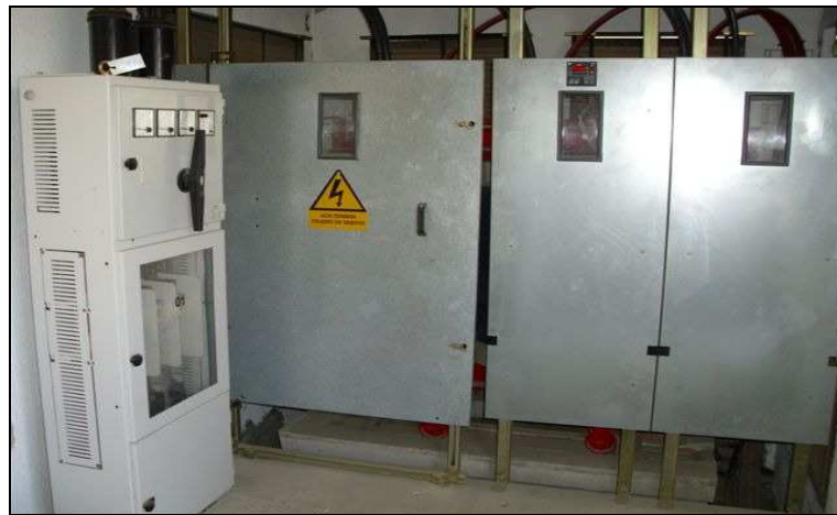
Figura 1.4 Transformadores aislados dentro de cuarto
