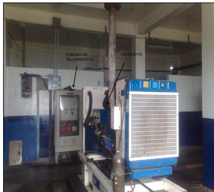
Figura 1.5 Electrógenos de la central-repetidora de CNT Fuente: Repetidora Santa Ana (cortesía de la Corporación Nacional de Telecomunicaciones, CNT).
