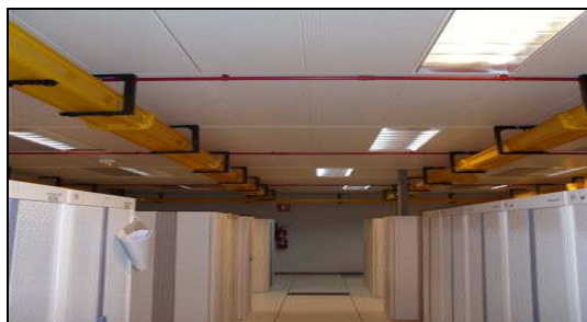
Figura 1.10 Sistema contra incendio en un data center
