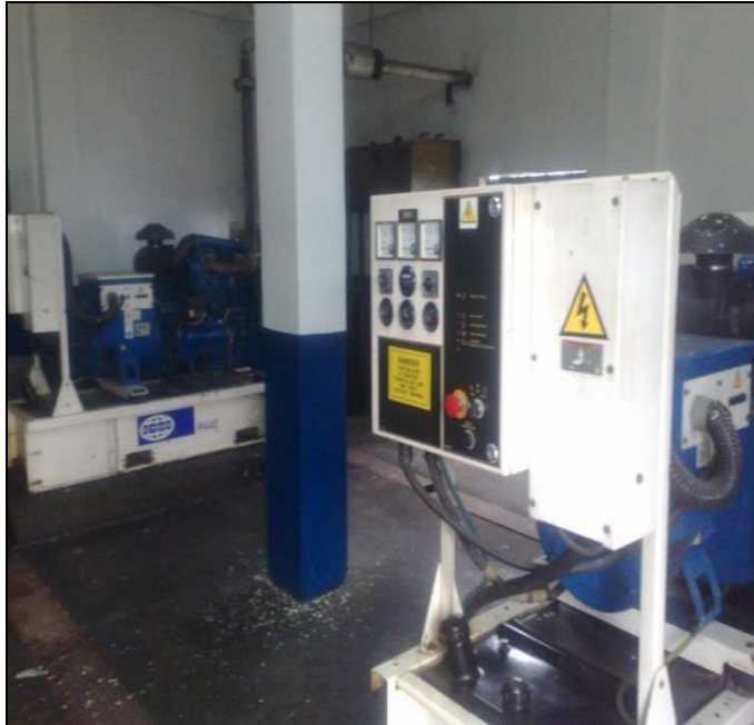
Figura 1.7 Sistema electrógeno redundante (1+1), repetidora Santa Ana Fuente: Repetidora Santa Ana (cortesía de la Corporación Nacional de Telecomunicaciones, CNT).
