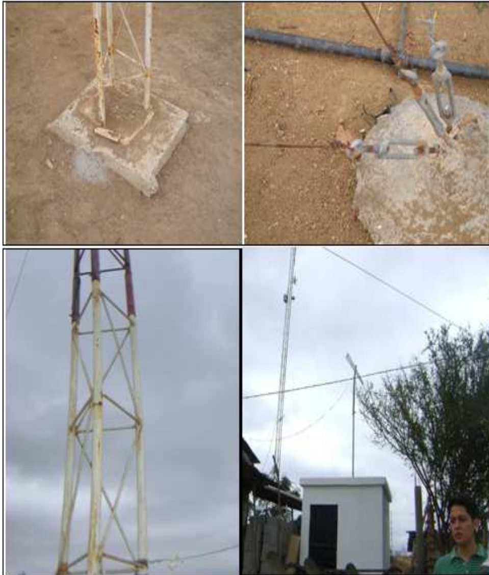
Figura 4.2 Estado de la estructura de la Torre de Limoncito
