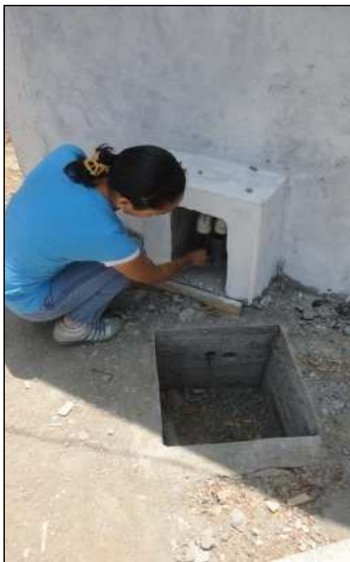
Figura 5.3 Conexión del cuarto con sistema de tierra (caja)
