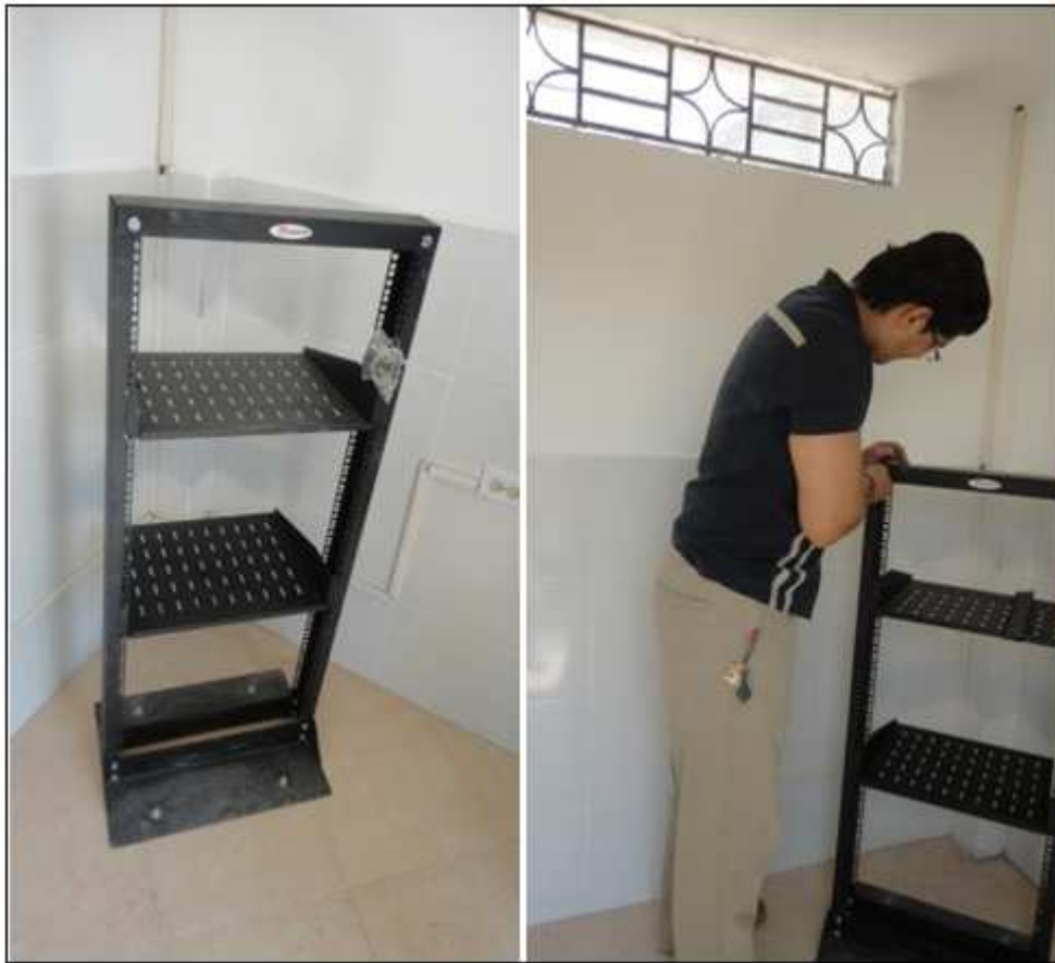
Figura 5.2 Rack del cuarto de Equipos en Limoncito
