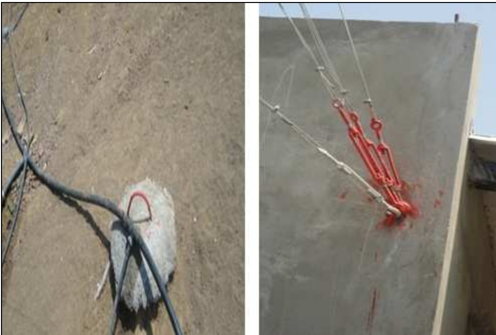
Figura 4.22 Reordenamiento seguro de anclajes para vientos
