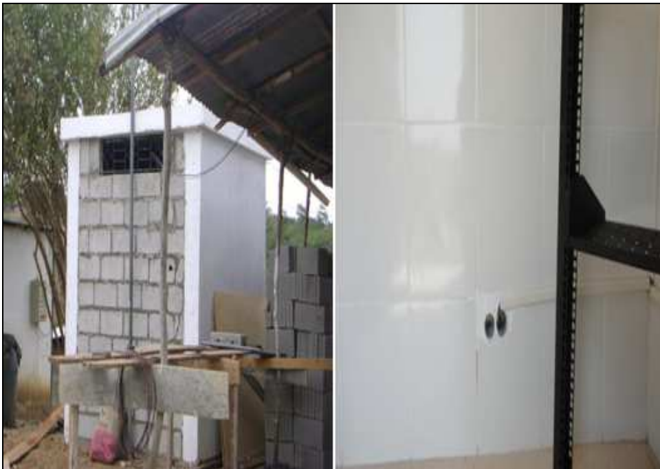
Figura 5.1 Cuarto de equipos de Limoncito, paredes con cerámica
