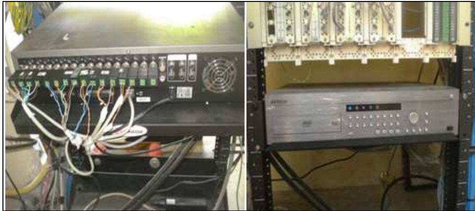
Figura 4.8 DVR ubicado en el rack de telecomunicaciones
