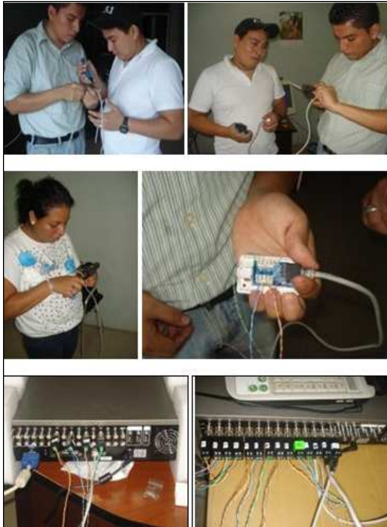
Figura 4.6 Conexión de balun´s con cámaras hacia DVR
