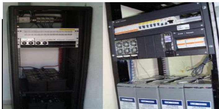
Figura 1.9: Equipos Rectificador, de control y baterías de 2 power plant Fuente: los autores
