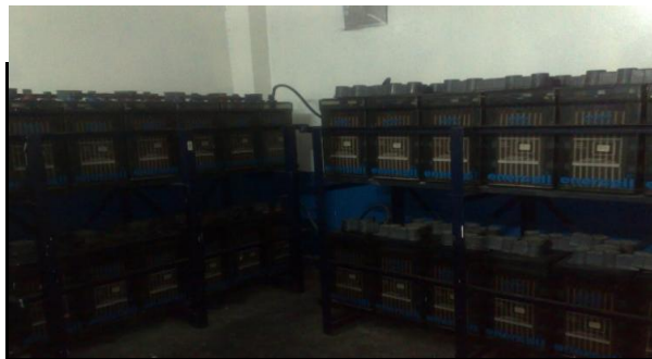
Figura 1.22: Respaldo banco de baterías en repetidora santa Ana-CNT Fuente: los autores
