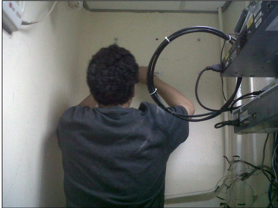
Figura 7.12 Instalación del rack, perforación la pared y se colocó pernos ancla para el soporte por parte de nuestro compañero Fernando Espinoza.
