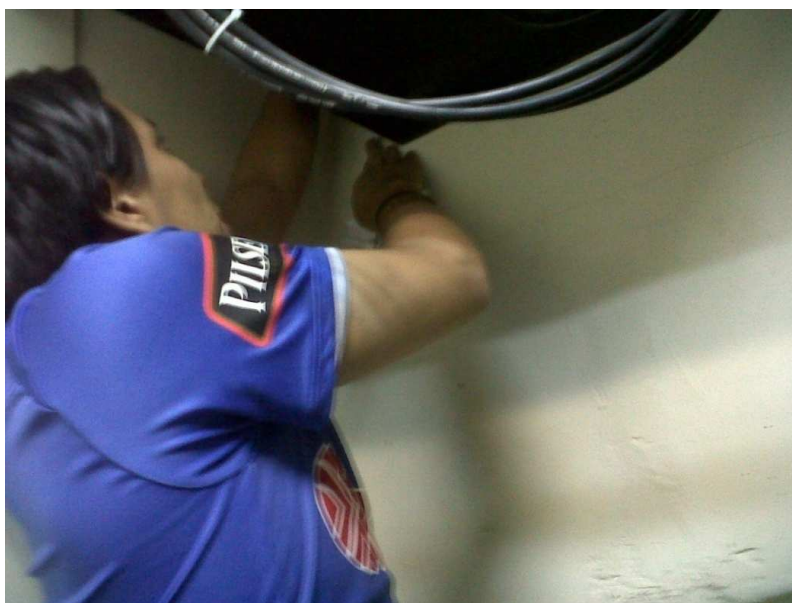
Figura 7.26 Puesta de caja para punto de red y conexión directa hacia el equipo BlueServer por parte de nuestro compañero Dennys Espin. Fuente: Proyecto de Tesis
