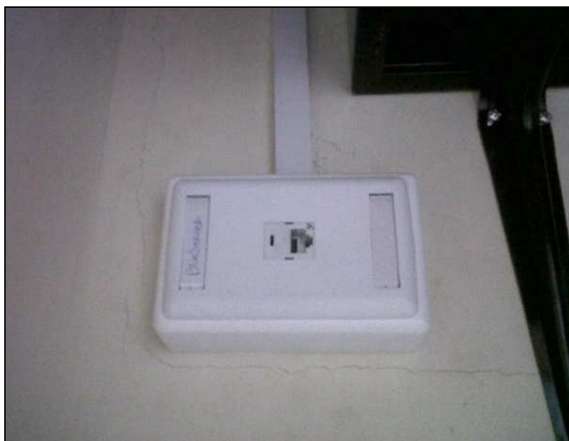
Figura 7.27 Instalación completada del punto de red Fuente: Proyecto de Tesis
