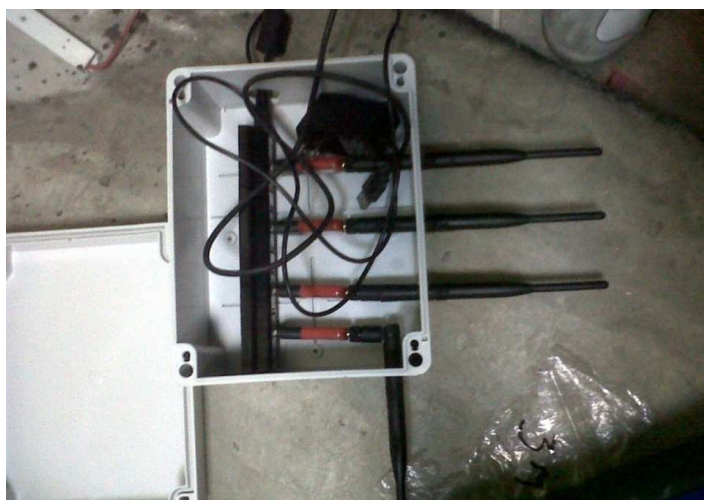
Figura 7.28 Caja con grupo de 4 antenas se ubicaran en la parte exterior del cuarto de rack de la Facultad Técnica en el costado derecho.
