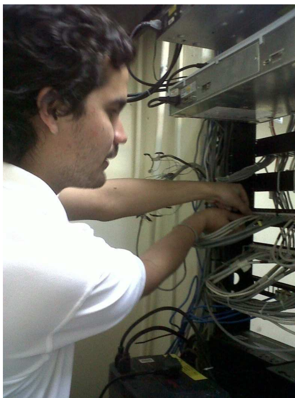
Figura 7.24 Ubicación e instalación del jack en el patch panel dentro del rack de la Facultad Técnica por parte de nuestro compañero Jorge Cortez
