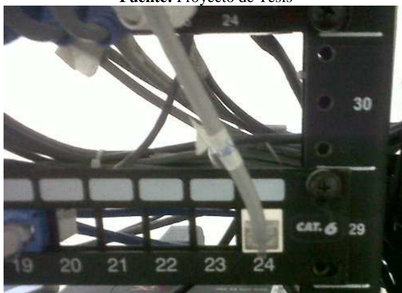
Figura 7.25 Una vez instalado el jack en el patch panel tenemos disponible el puerto Ethernet para la conexión del patchcord.
