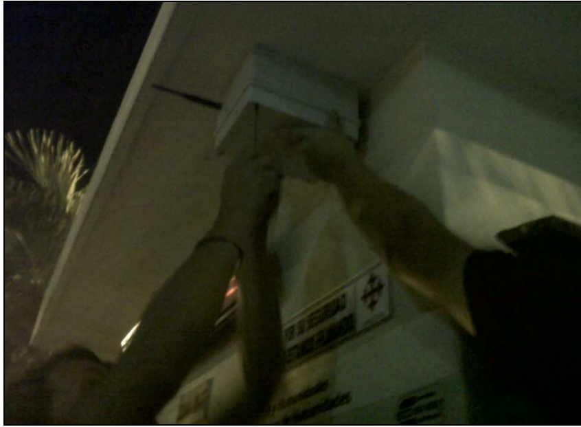
Figura 7.21 Antenas instaladas Fuente: Proyecto de Tesis
