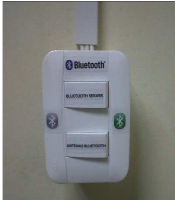
Figura 7.17 Interruptor para prendido/apagado del equipo BlueServer y de antenas Bluetooth de nuestro proyecto.
