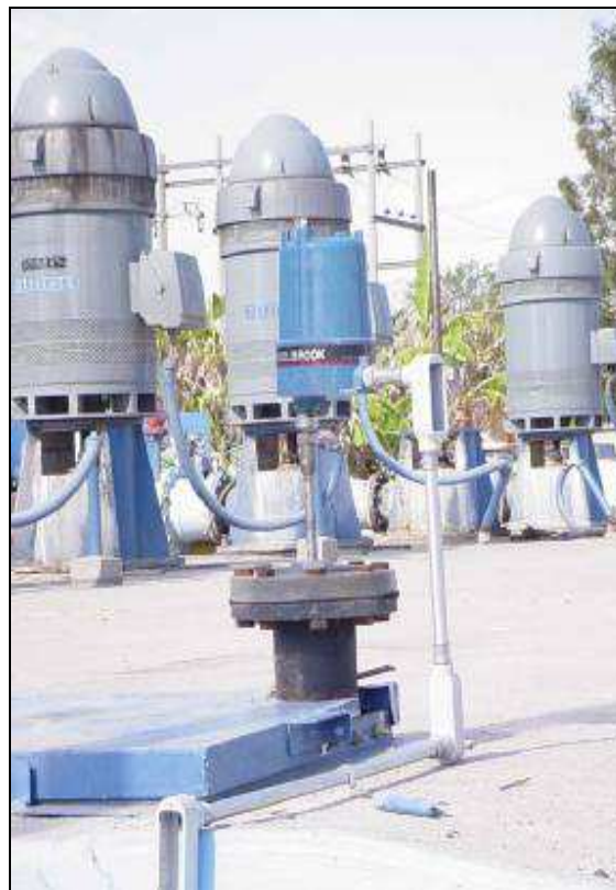
Fig. 3-11 Sensores de nivel
