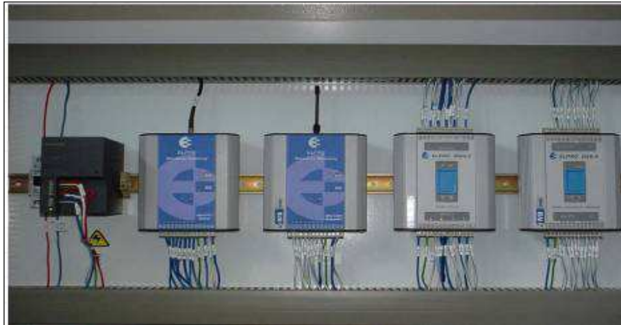
Fig. 3-6 Instalación de la Instrumentación Industrial
