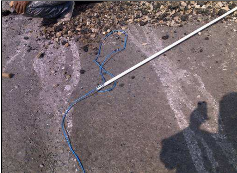
Figura 5-4 Acometida eléctrica en tubos para las torres de las barreras
