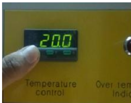
Figura 20 Control de Temperatura 20 grados
