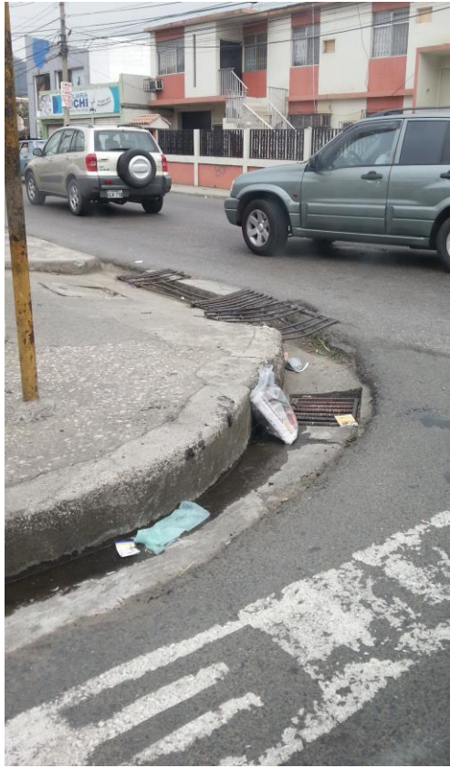
Sumidero con presencia de basura cerca.
