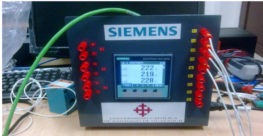
Figura 4.39: Monitoreo de los voltajes en las fases. Fuente: Autores del documento
