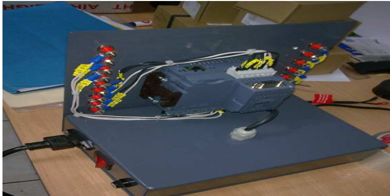
Figura 4.26: Señalización de líneas del cableado Fuente: Autores del documento
