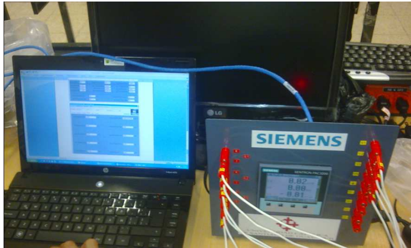
Figura 4.42: SENTRON PAC 3200 en medición. Fuente: Autores del documento
