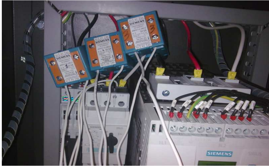
Figura 4.35: Transformador de corriente de 50 a 5 A atravesados en las fases L1, L2, L3. Fuente: Autores del documento
