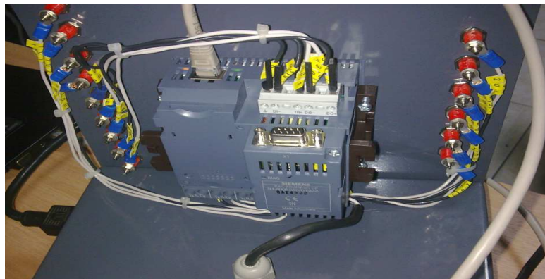
Figura 4.27: Conexión en red para la supervisión de procesos energéticos (eléctricos) Fuente: Autores del documento
