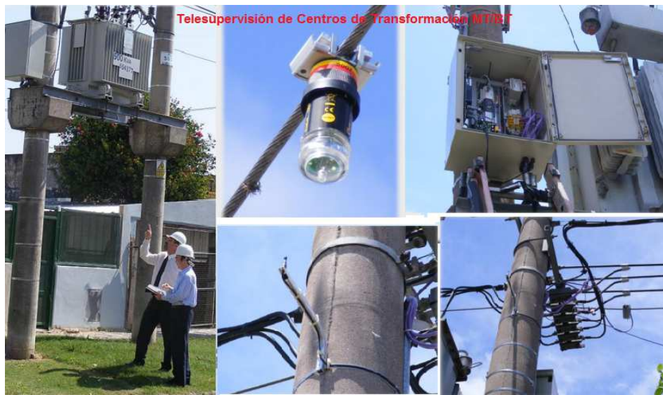
Figura 2. 13 Telesupervisión a centros de transformadores de MT y BT
