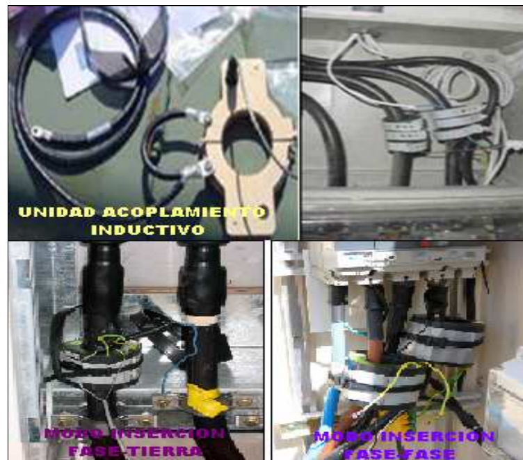
Figura 4. 12 Unidad de acoplamiento inductivo BT y modos de inserción (Energy Groove, 2013)
