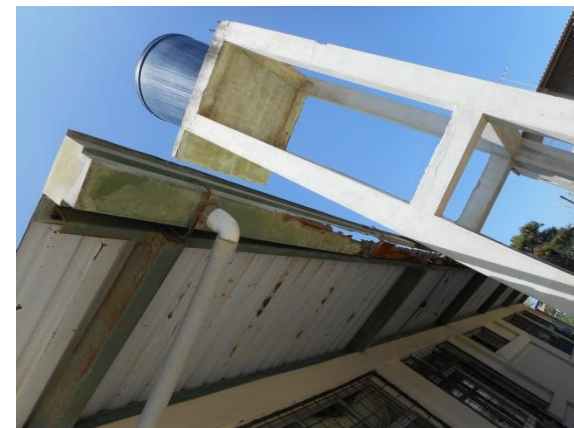
Figura 8: canalones deteriorados Fuente: elaboración propia
