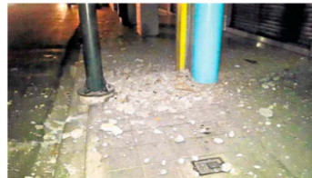
El fuerte movimiento sísmico ocasionó desprendimientos de la fachada de los edificios.
