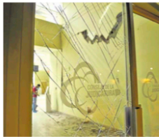
Se ve cómo se caen pedruzcos de los edificios en cuartos, como el del caso de la cafetería.
