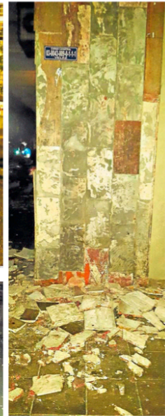
Daños de traza y barrotes se desprendieron en varias partes de Guayaquil.
