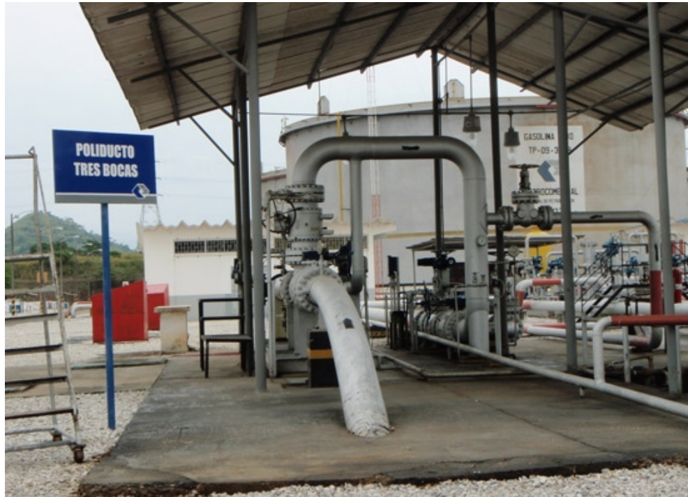
Foto 1 – Poliducto TRES BOCAS - SALITRAL
