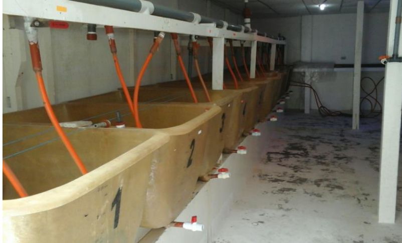
Foto 1. Tanques de tratamientos
