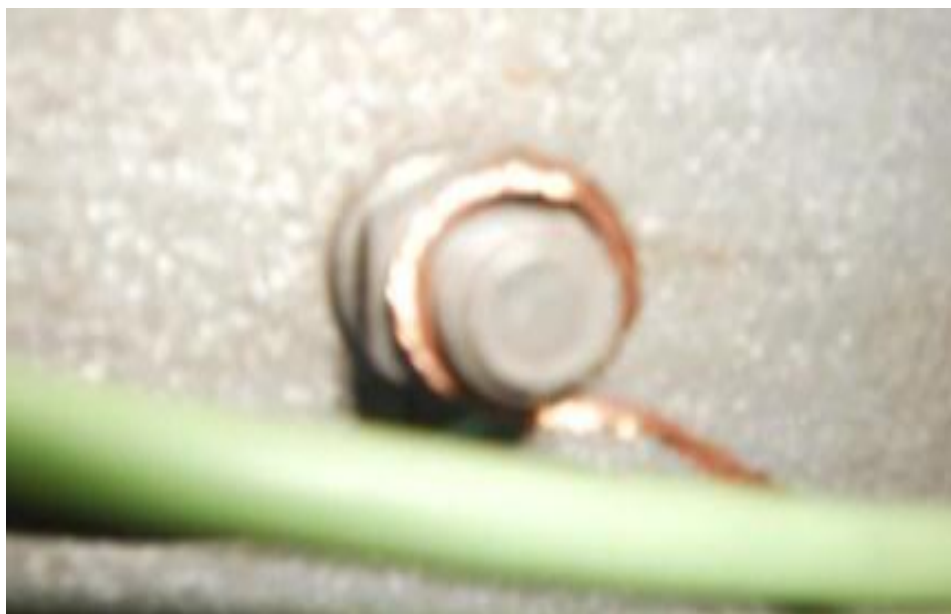
Figura. 3.14: Aterrizamiento de los Equipos Elaborado por: Autor
