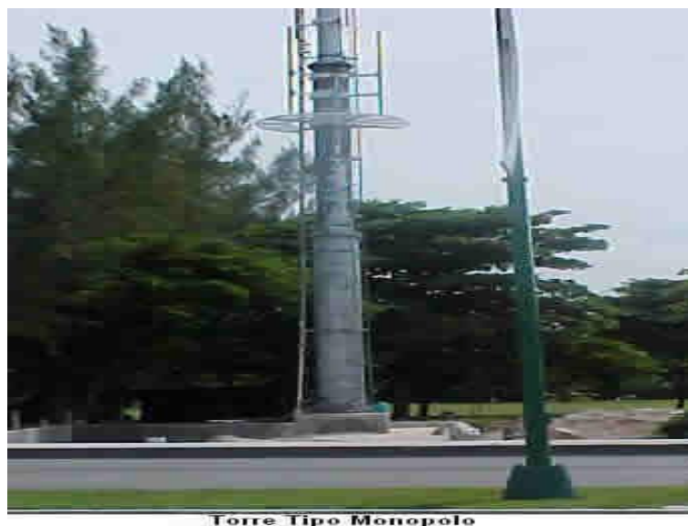
Torre Tipo Monopolo
