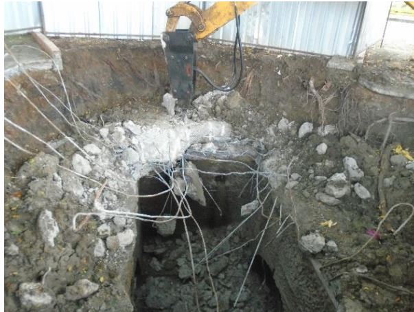
Imagen 6: Rotura de losa de la cámara N° 23
