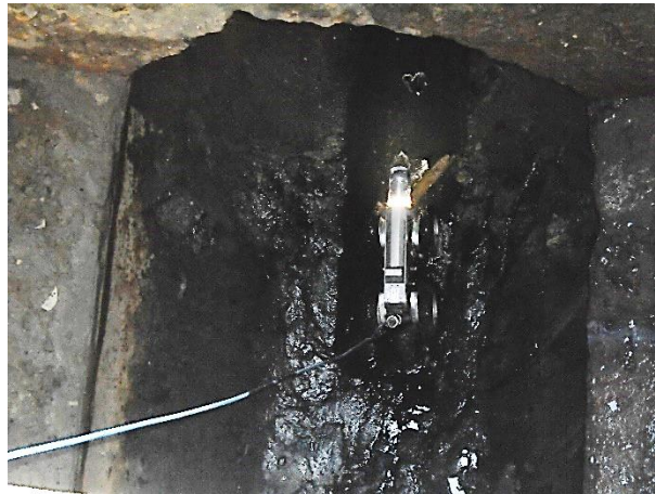
Imagen 18: Inspección televisiva con el robot dentro del tramo entre las cámaras N° 9 y 10.
