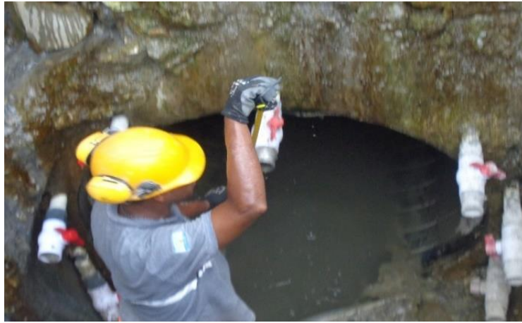
Imagen 23: Llaves de paso donde se conecta la manguera que inyecta el mortero fluido
