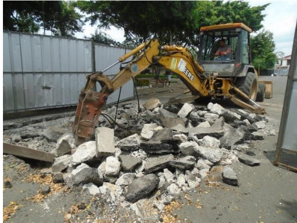
Imagen 4: Rotura del pavimento sobre la cámara N° 16
