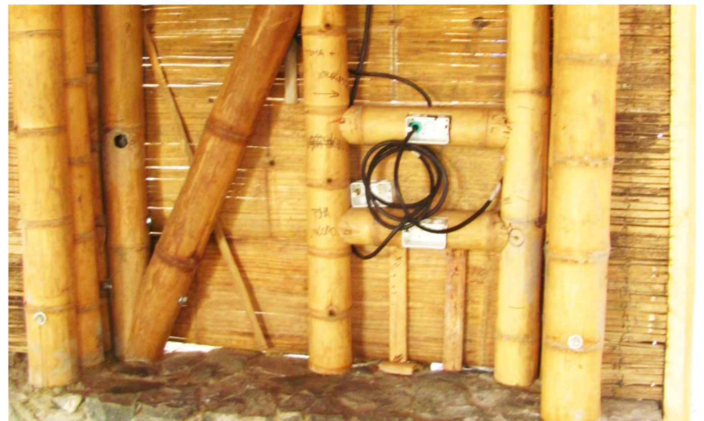
Foto 14: Instalaciones eléctricas entre paneles de caña en muro de bahareque. Autor: Báppler, A. (2014)
