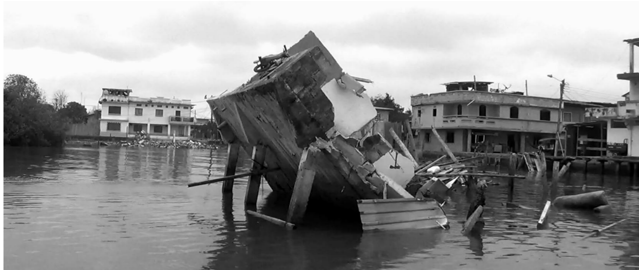
Foto 2: Viviendas palafíticas colapsadas. Autor: Gómez, E. (2016)
