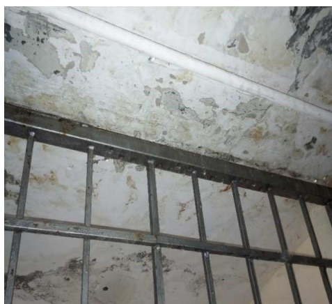
Figura 7: filtración de losa en escalera Fuente: elaboración propia
