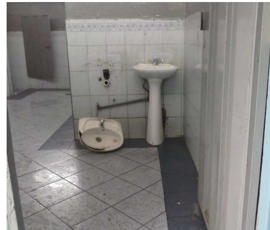
Figura 5: baterías sanitarias niños Fuente: elaboración propia
