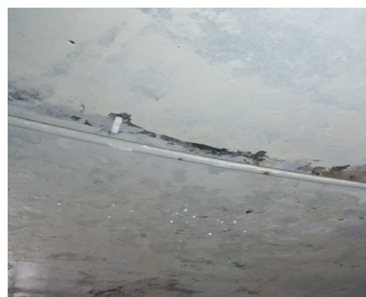
Figura 8: filtración central en losa Fuente: elaboración propia
