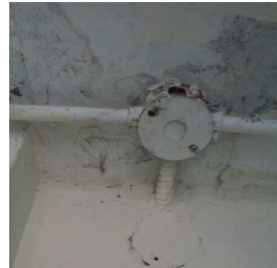
Figura 9: instalación eléctrica vista Fuente: elaboración propia
