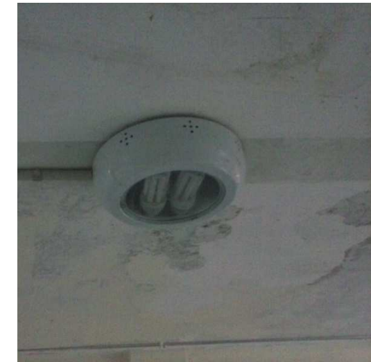
Figura 10: luminaria sobrepuesta Fuente: elaboración propia
