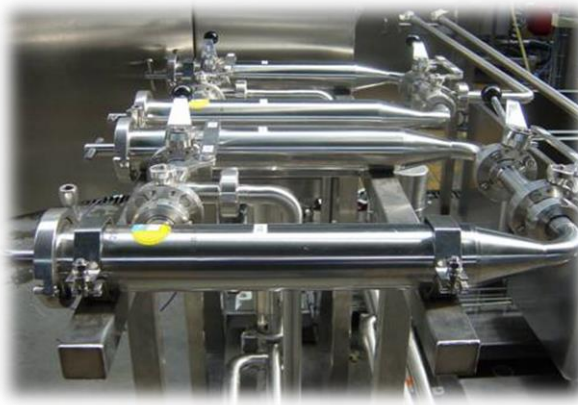
Figura 24: Filtración y Almacenamiento
