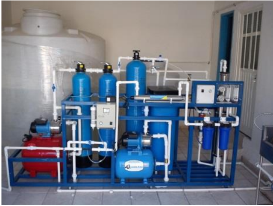
Figura 42: Planta Purificadora de agua
