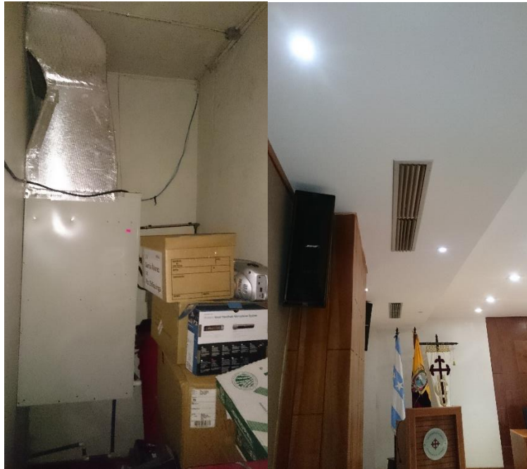
Figura 28. Equipos de climatización y Salida de la ducteria de A/C
