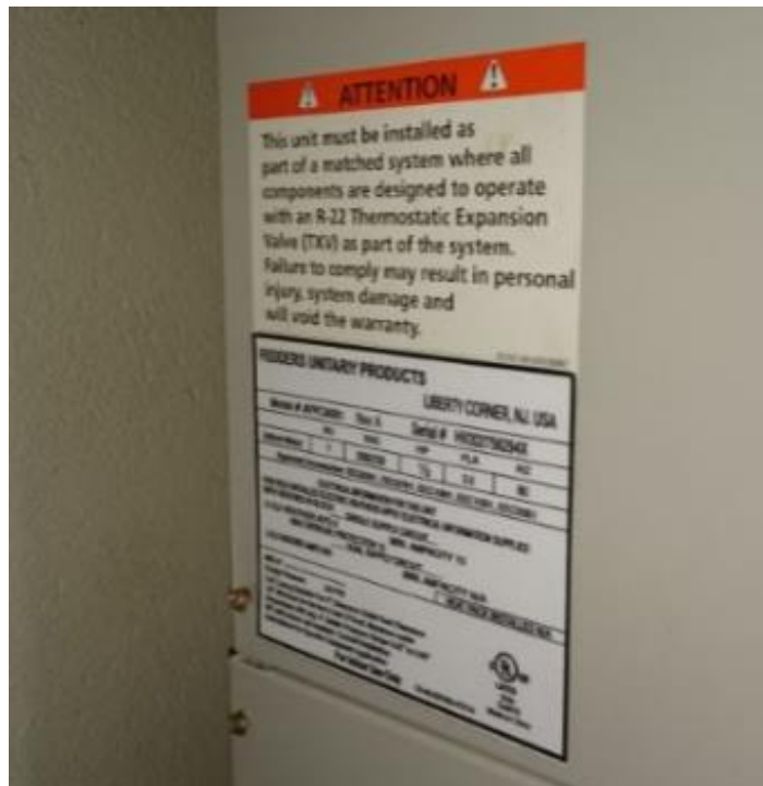
Figura 27. Placa de especificaciones de las centrales de A/C
