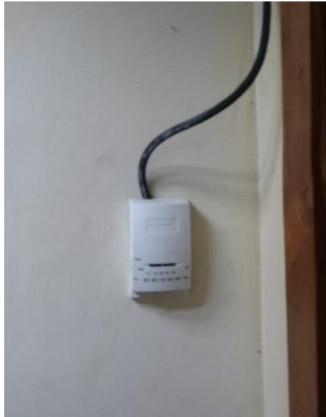
Figura 29. Controlador de Temperatura
