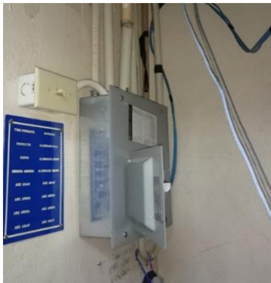
Figura 26. Panel de distribución
