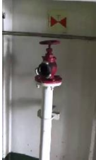
Figura 3.9 Conexión para el abastecimiento de agua
