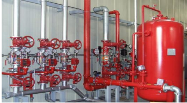
Figura 2.23: Sistema fijo de extinción por espuma Fuente: Bleye Vicario (2012)
