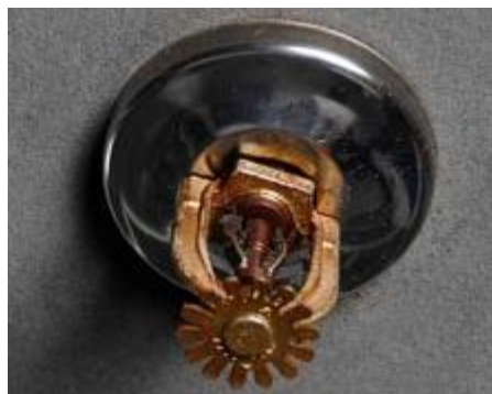
Figura 3.19 Rociador contra incendio.
