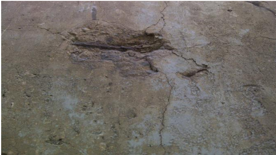
Figura 46. Efectos de la Corrosión en la viga.
