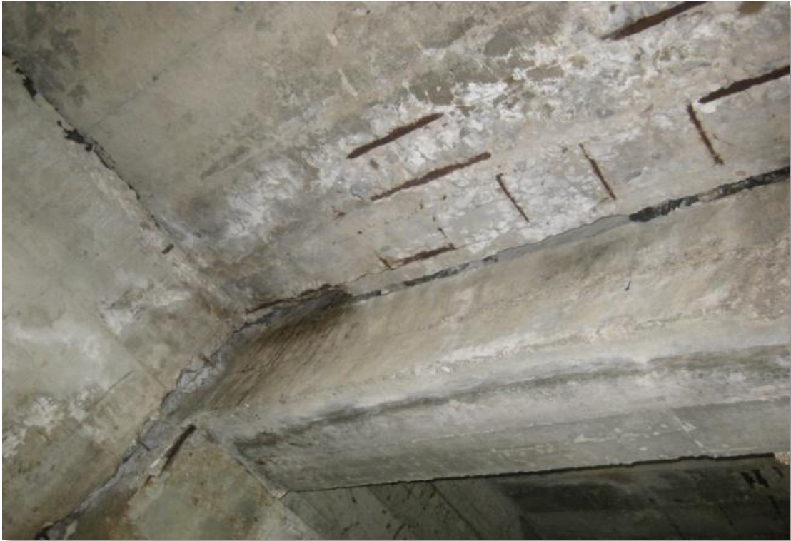
Figura 44. Efectos de la Corrosión en la viga.
