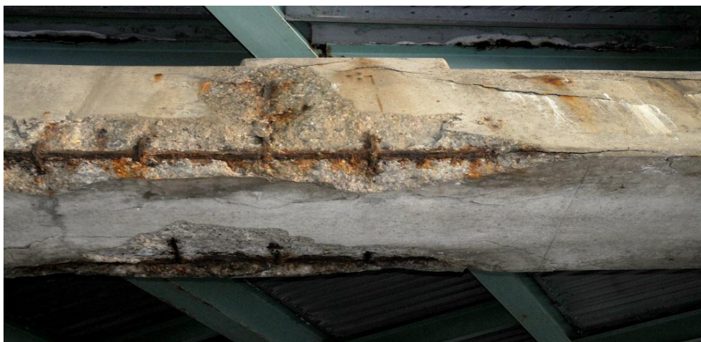
Figura 43. Efectos de la Corrosión en la viga.
