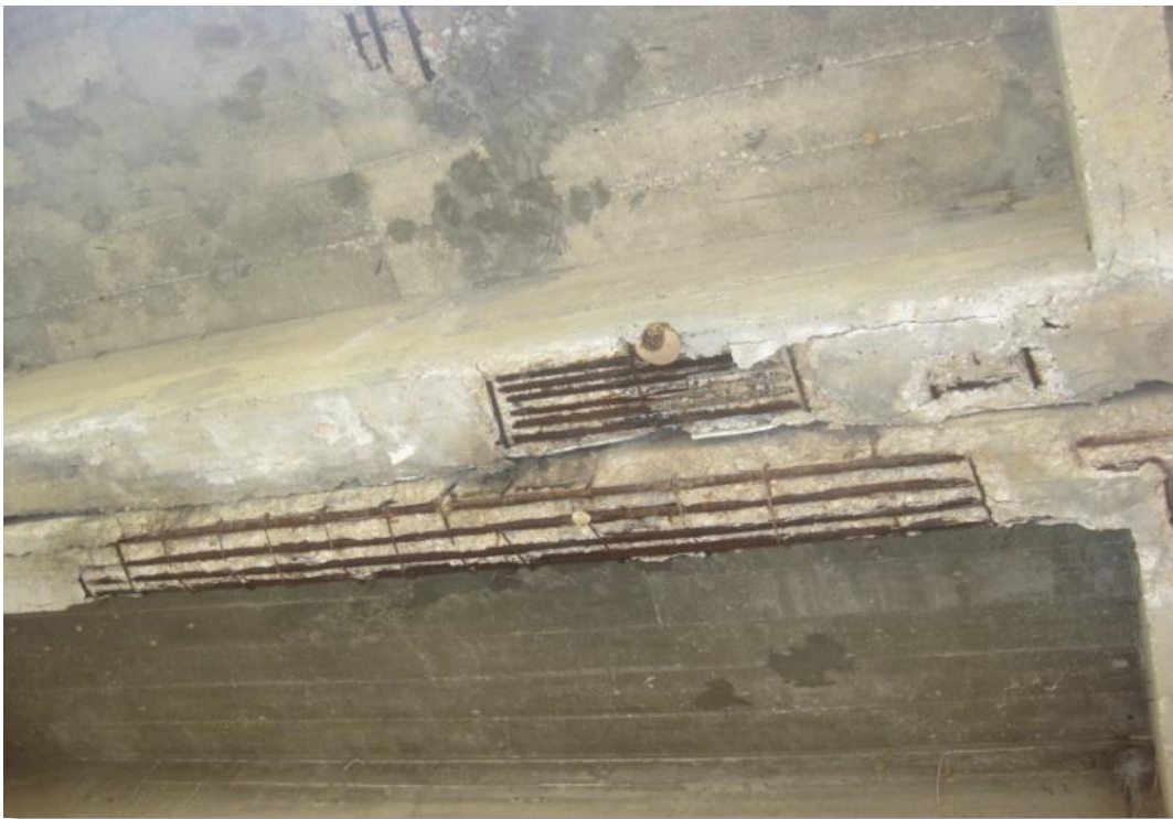
Figura 45. Efectos de la Corrosión en la viga.
