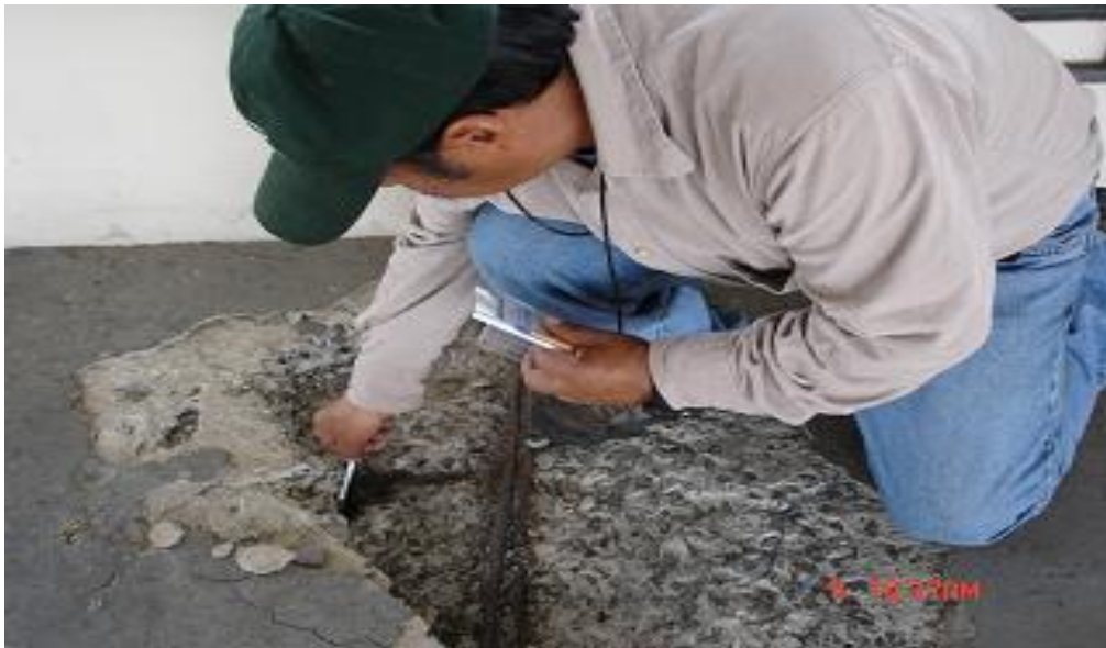
Figura 47. Efectos de la Corrosión en la viga
