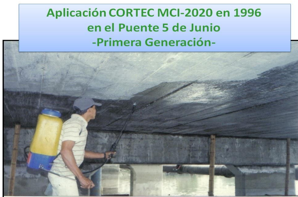
Figura 48. Efectos de la Corrosión en el Puente 5 de Junio.
