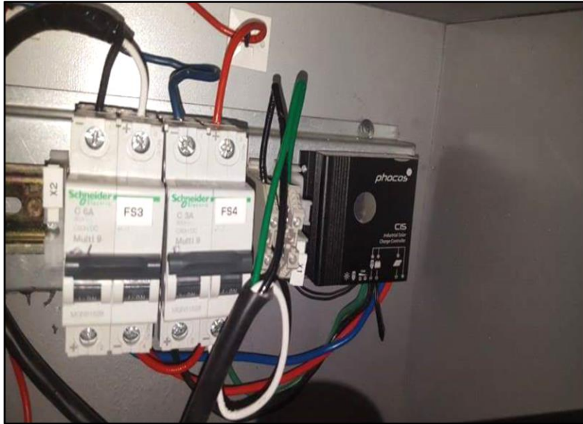
Imagen 7.5: Conexión del circuito de protección de los equipos Fuente: El Autor
