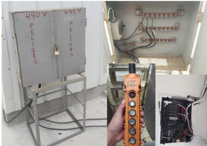
Figura 3. 16: Tablero provisional, botonera de control y caja de breaker en mal estado.
