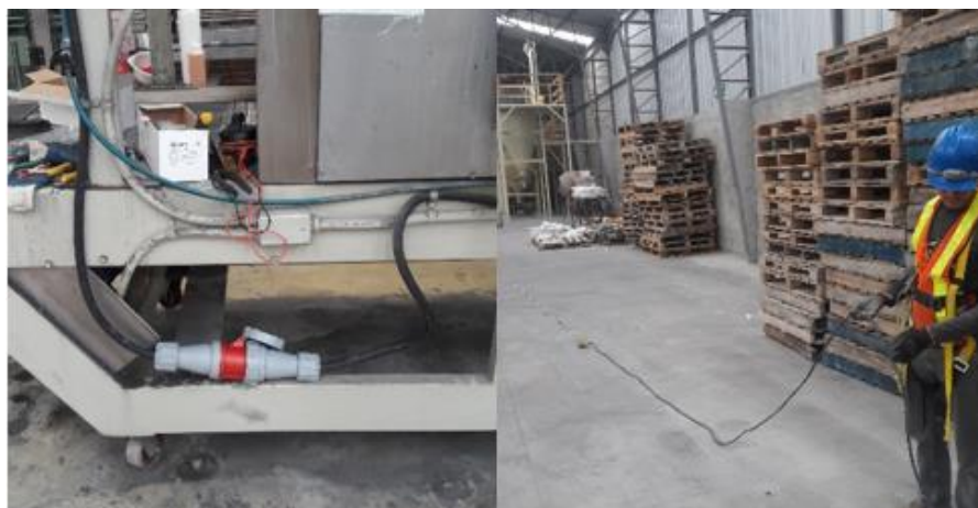
Figura 3. 18: Presencia de enchufes y tomas industriales, extensiones eléctricas en buen estado.
