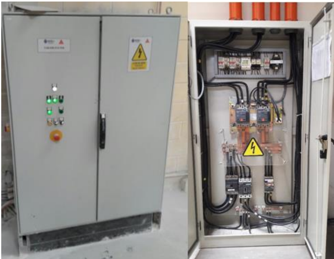
Figura 3. 20: Tableros eléctricos con su debida señal de peligro. Fuente: Fotografías tomadas en visita técnica.
