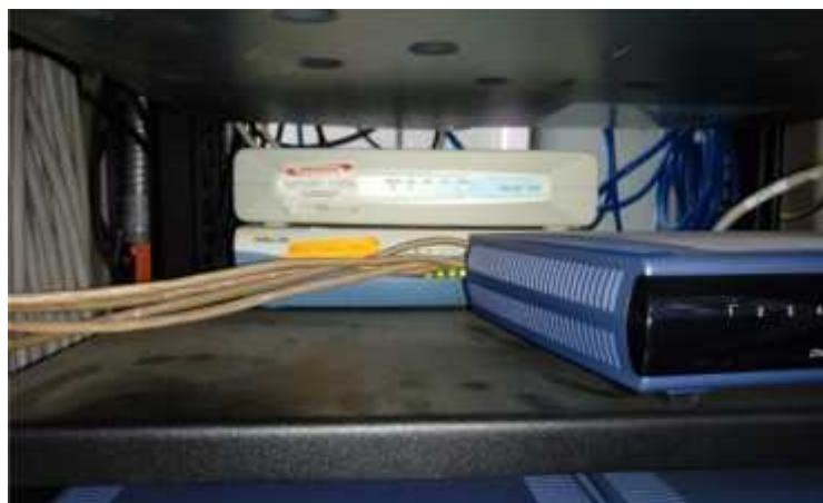
Figura 3.24 Equipos Airmux 200 ubicados en la bandeja del rack del cliente less-Cuenca
