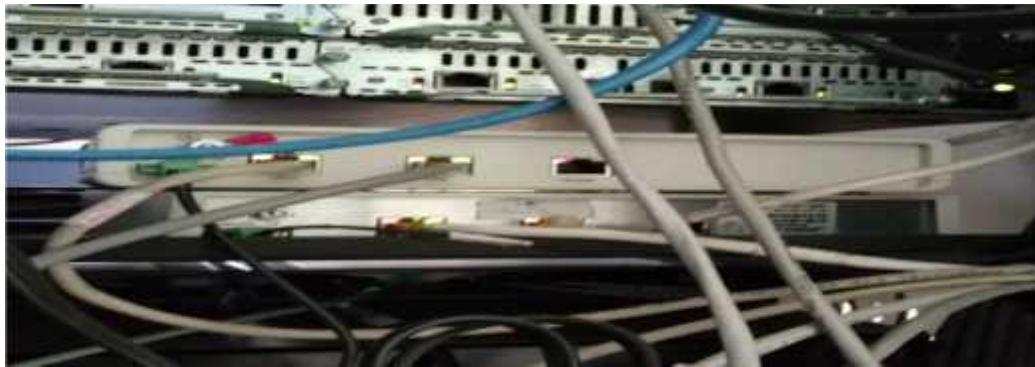
Figura 3.22 Conexión de los equipos Elaborado por: La autora
