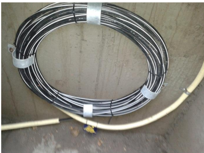
Figura 2.35: Porta reserva en Pozo Fuente: El Autor
