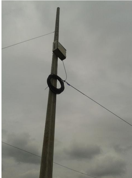
Figura 2.28: Poste de hormigón Fuente: El Autor
