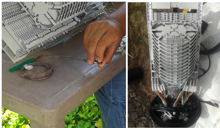
Figura 2.27: Splitter - Manga porta Splitter Fuente: El Autor
