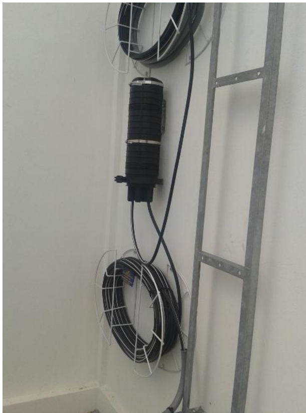
Figura 2.34: Porta reserva en galería de cables Fuente: El Autor
