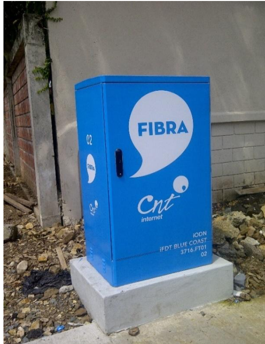
Figura 2.22: Armario de Fibra óptica Fuente: El Autor
