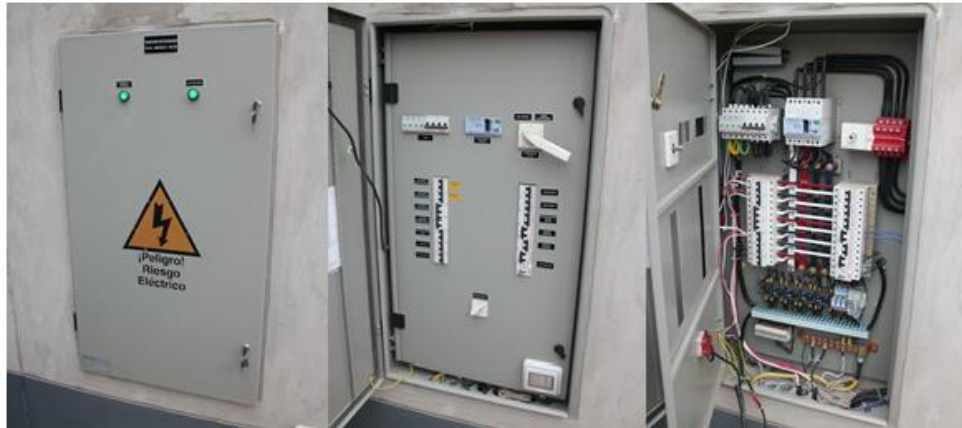
Figura 2. 1: Tablero de Energía de una RB
