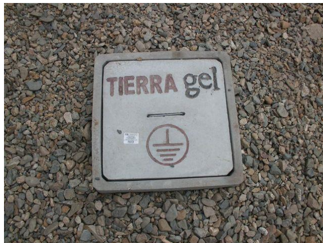
Figura 2. 2: Pozo a tierra
