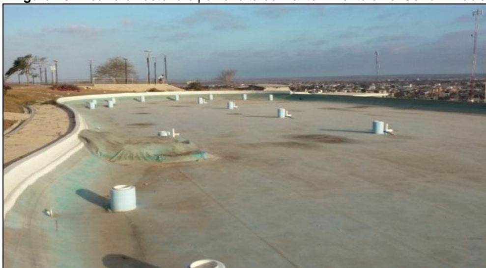
Figura 25: Piscina en deterioro por la falta de mantenimiento en el Cerro El Tablazo
