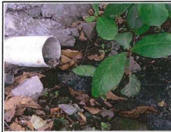
Fig. 3.7. Tubería clandestina en las coordenadas (X 621529 – Y 9759241)
