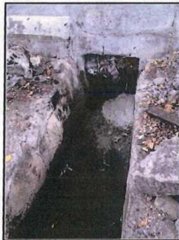
Fig. 3.6. Tubería sellada por la compañía POLICONSTRUC S.A.
