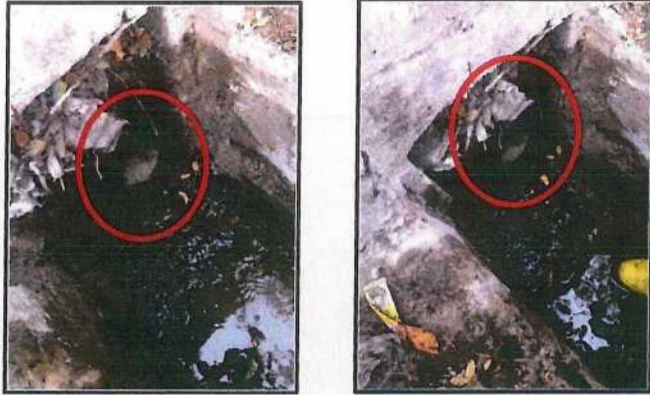
Fig. 3.3. Tubería clandestina en las coordenadas (X 621517 – Y 9759223)
