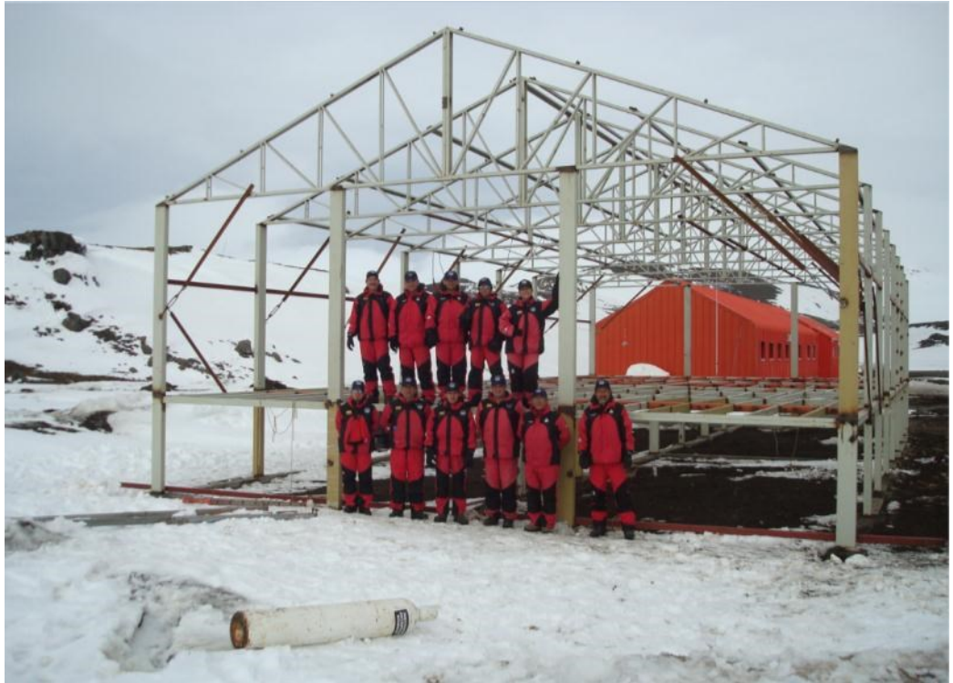
Foto 18. Estado de la Estructura metálica del Módulo 4 el 12-FEB-2010, junto al personal militar y civil que intervino en la construcción.
